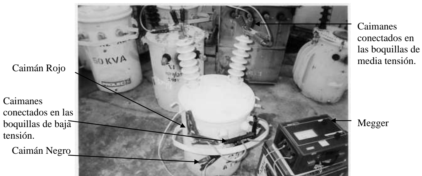
Figura 3.22 Prueba de un transformador de dos boquillas de baja tensión con tanque.
