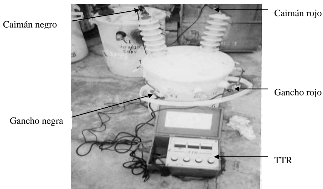
Figura 3.13 Prueba para el segundo devanado de un transformador con dos boquillas
