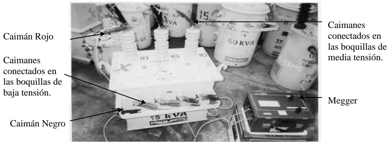
Figura 3.24 Prueba de un transformador de tres boquillas de alta tensión con tanque.
