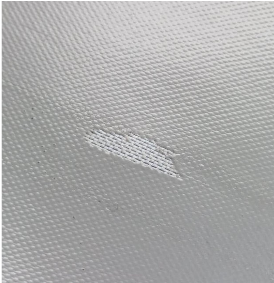
Ilustración 8 Defecto Falta de Capa de Plastificado
