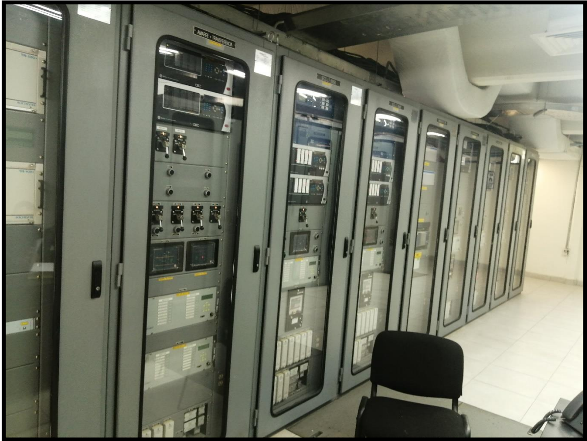
Figura 46 SE ATD Caseta de control
