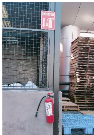
Figura 16.- Extintor ubicado en el exterior del Almacén de Residuos Peligrosos.
