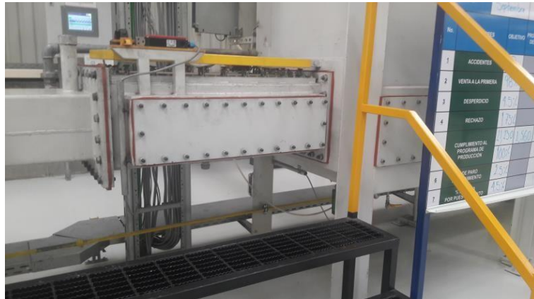
Ilustración 22 Pinch roll principal
