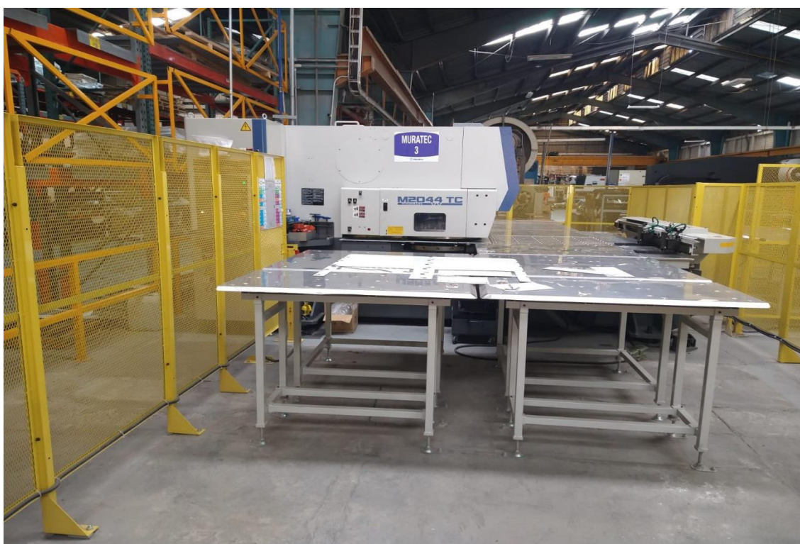
Ilustración 35. Maquina Muratec 3 instalada y trabajando de manera normal.
