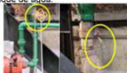
Ilustración 4 Válvulas de agua.
