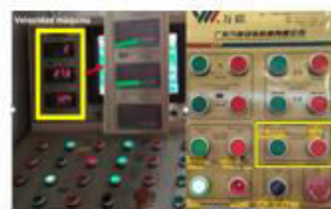
Ilustración 21 Tableros de control cabezal B/E.
