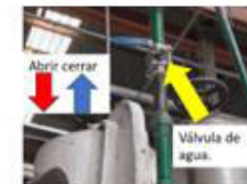
Ilustración 19 Válvula agua tanque adhesivo.
