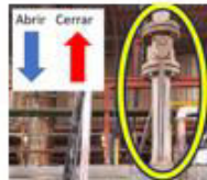
Ilustración 13 Válvula alimentación de vapor.
