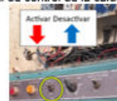
Ilustración 9 Interruptor encendido caldera.
