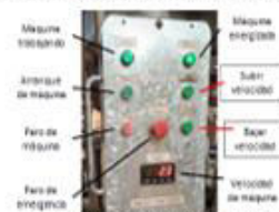
Ilustración 20 Tablero de control cabezal C.
