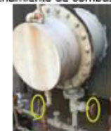
Ilustración 45 Válvulas de suministro combustible.
