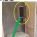
Ilustración 11 Caja de centro de carga principal cabezal B/E.
