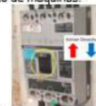
Ilustración 2 Caja de centro de carga principal.
