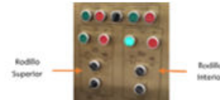
Ilustración 9 Tablero mando D.E.
