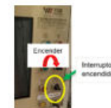
Ilustración 1 Interruptor encendido tablero corte transversal.
