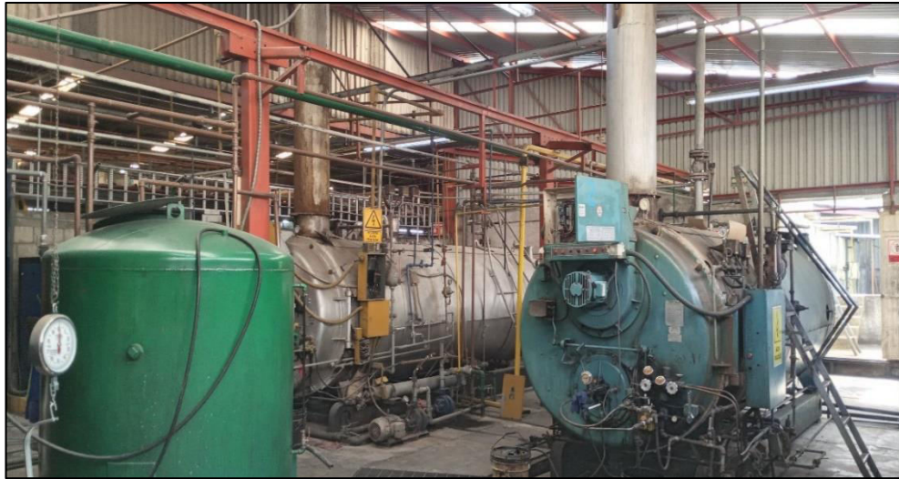
Ilustración 36 Calderas cuarto de máquinas.
