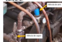
Ilustración 38 Válvulas de aire y vapor.
