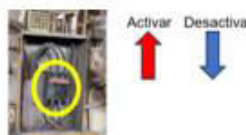
Ilustración 7 Caja de centro de carga caldera.
