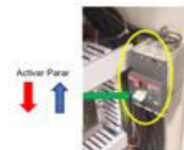
Ilustración 14 Pastilla activación puente de almacenamiento B/E.
