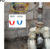
Ilustración 26 Bomba y válvula de suministro adhesivo.
