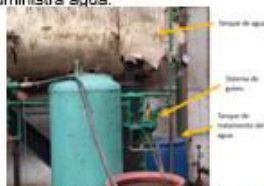
Ilustración 40 Tanque de tratamiento de agua.
