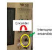
Ilustración 1 Interruptor encendido tablero corte transversal.
