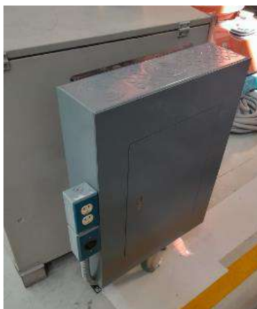
Figura A1-2 Caja de interruptores, se debe de revisar si todos los interruptores estén en la posición de encendido
