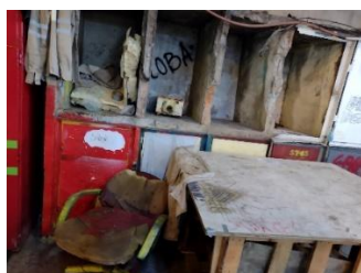
Ilustración 11 Gavetas en mal estado
