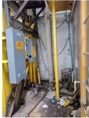
Ilustración 17 Espacios con escombros y basura
