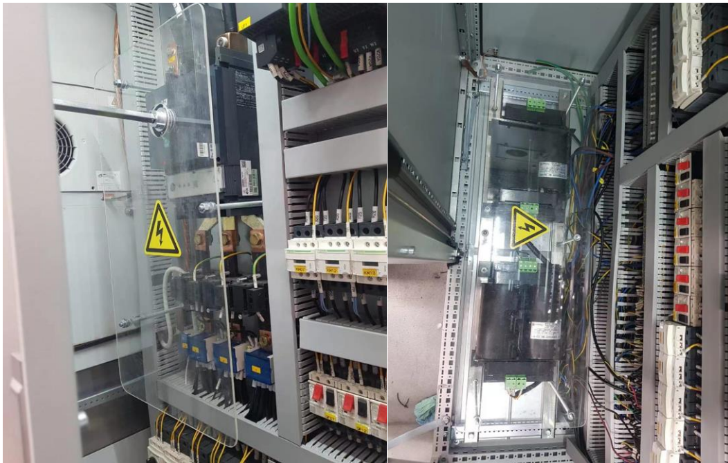
Figura 55. Gabinete eléctrico de alto voltaje.
