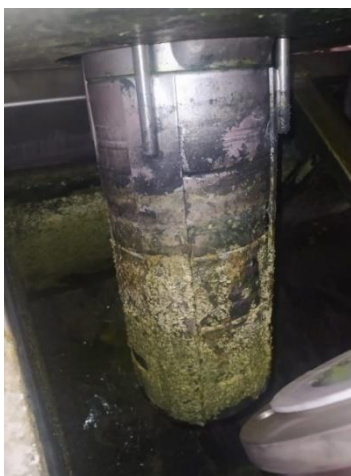
Figura 23. Impulsor lleno de suciedad
