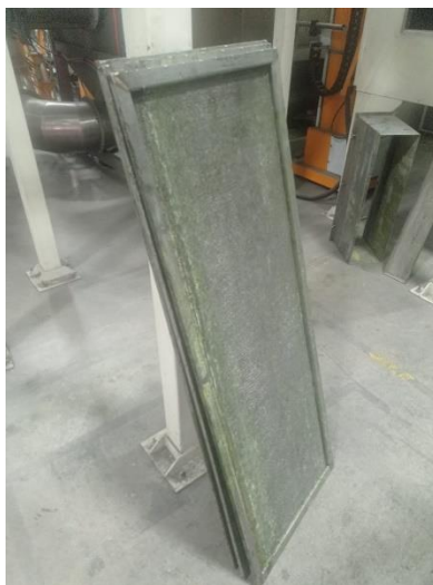
Figura 25. Filtros de los tanques de almacenamiento con suciedad.
