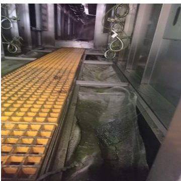
Figura 28. Malla filtro dañado.
