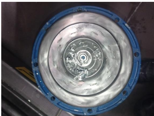
Figura 50. Bomba de reciclaje de agua lleno de suciedad en el impulsor.
