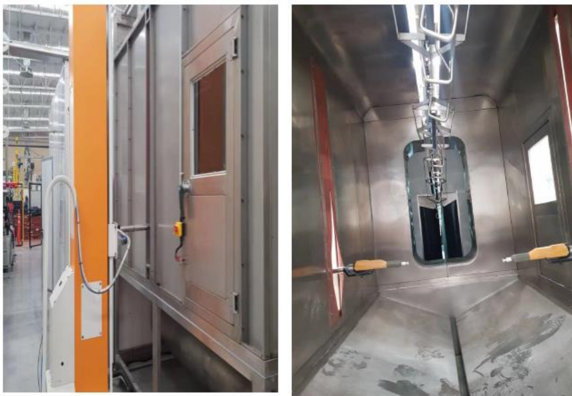
Figura 37. Cabina de aplicación de revelador.
