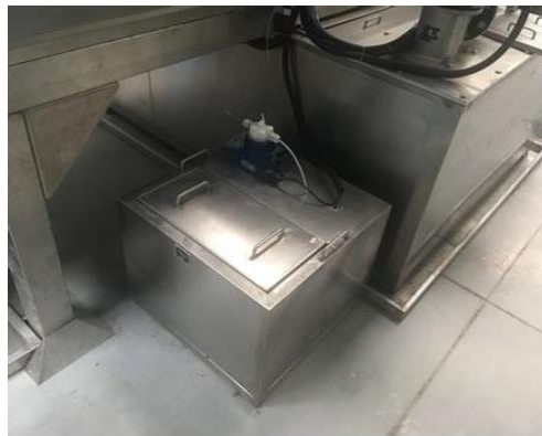
Figura 32. Estación de enjuague Anti foam tank.
