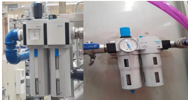
Figura 53. Filtros de regulación de aire.
