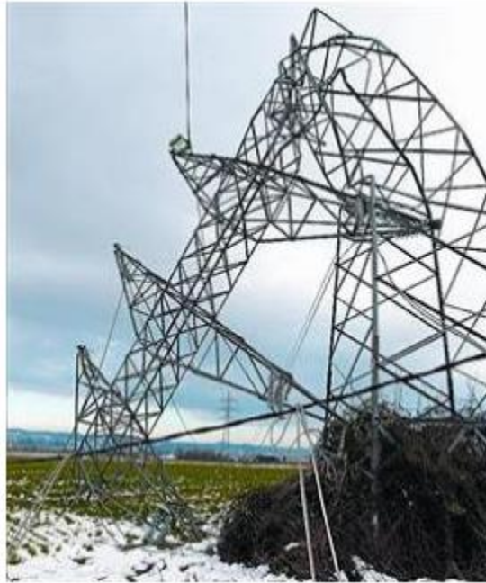
Anexo 1.- Daños a una torre
