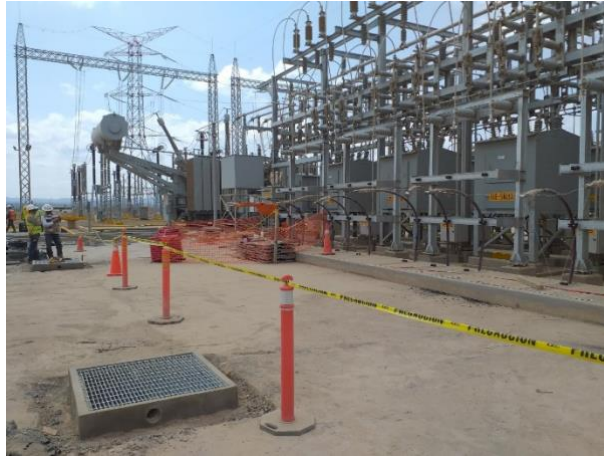
Figura 89.- Conexión del transformador (Imagen de referencia).
