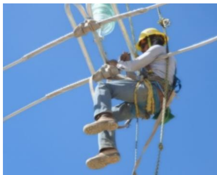
Figura 68.- Instalación de aisladores.
