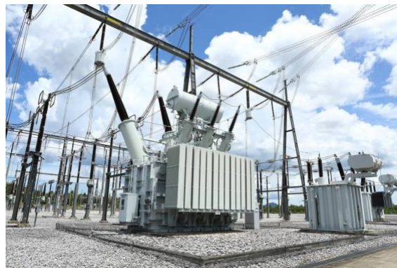
Figura 4.- Ejemplo de una subestación de maniobras.
