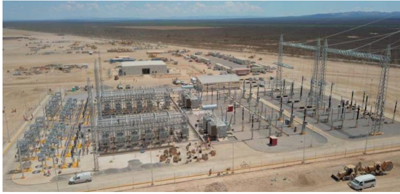
Figura 3.- Subestación Elevadora Tuli-Helios.
