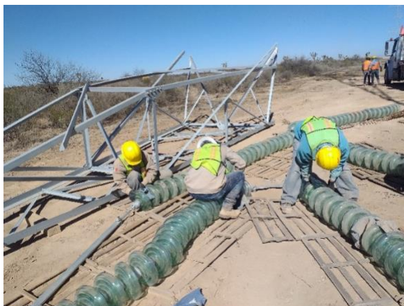
Figura 64.- Armado de la cadena de aisladores.
