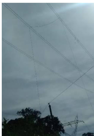
Figura 69.- Violín en cruce de media tensión. Obtenido de: García Sedas A. J., (2021). Reinstalación de cable de guarda en línea de transmisión de 400kV de Pachamama II.
