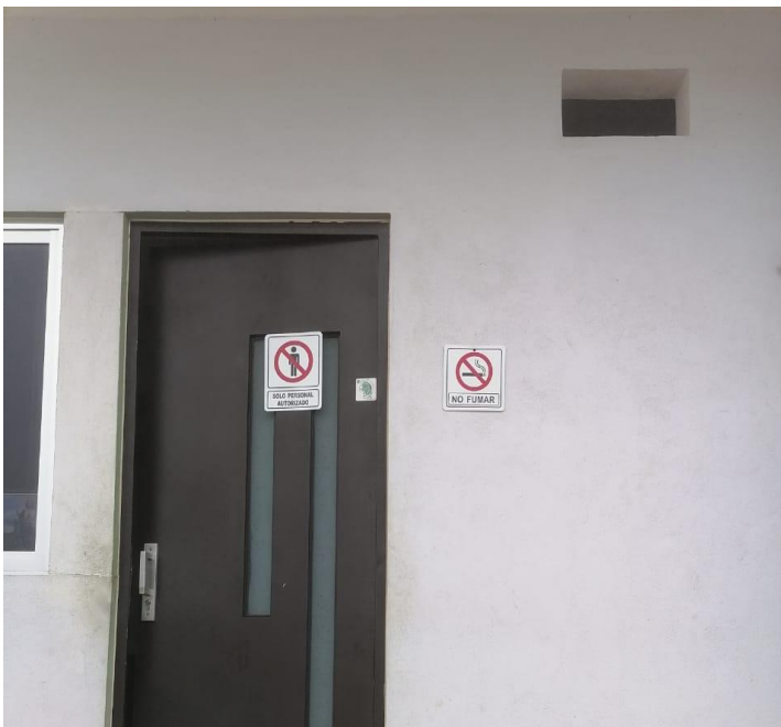
Imagen 38 No fumar y no personal autorizado
