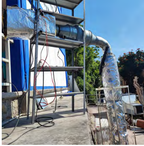
Figura 3.7. Intercambiador de calor aislado e instrumentado.
