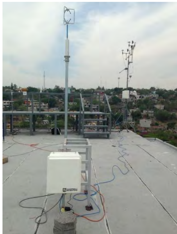
Figura 5.3 Anemómetro ultrasónico Wind Master 3D Gill Instruments en el edificio de posgrado del Instituto de Energías Renovables.
