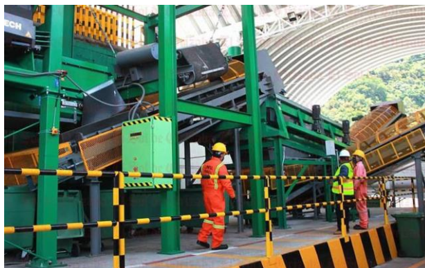
Figura 2.2 Planta separadora de residuos sólidos ECORI.
