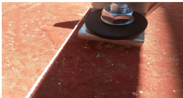
Imagen 11. Ejemplo de una correcta instalación del taquete químico.
