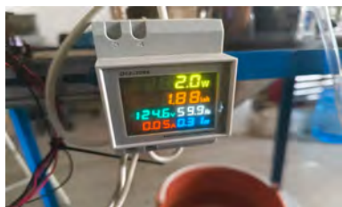
Figura 5.20: Se observa el watímetro que se encuentra en la estructura y mide la energía que entra al convertidor.
