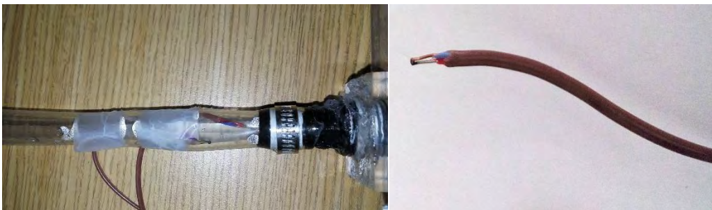
Figura 28. Termopar tipo T conectado a a la entrada y salida del agua de intercambiador de calor
