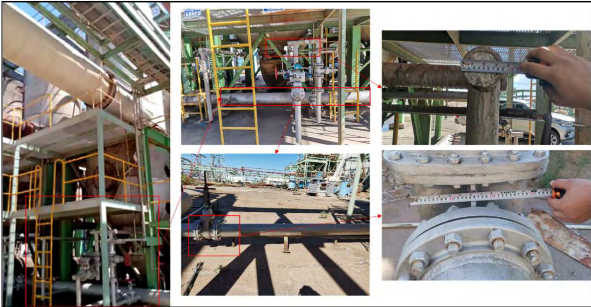
Fig. 28. Zona de estudio y toma térmica propuesta de la Unidad 5.
