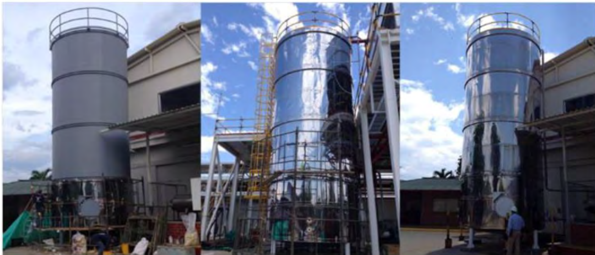
Fig. 30. Tanque de almacenamiento comercial de 100 m 3 de acuerdo con la demanda de refrigeración.
