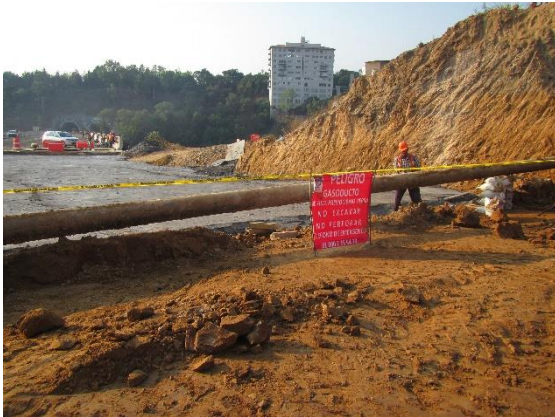
GASEODUCTO EN ESPERA DE REUBICAR LÍNEA.
