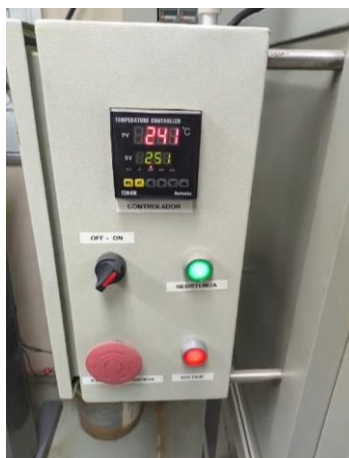
Figura 112: Panel de control del horno mufla.
