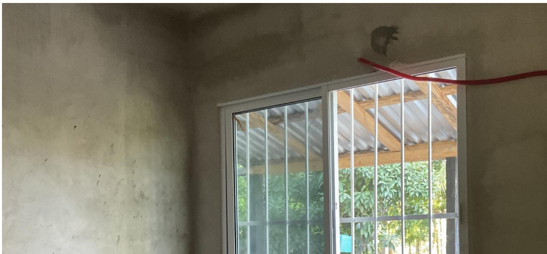
Imagen 26. Instalación eléctrica en una vivienda tipo P3 en Palmar
