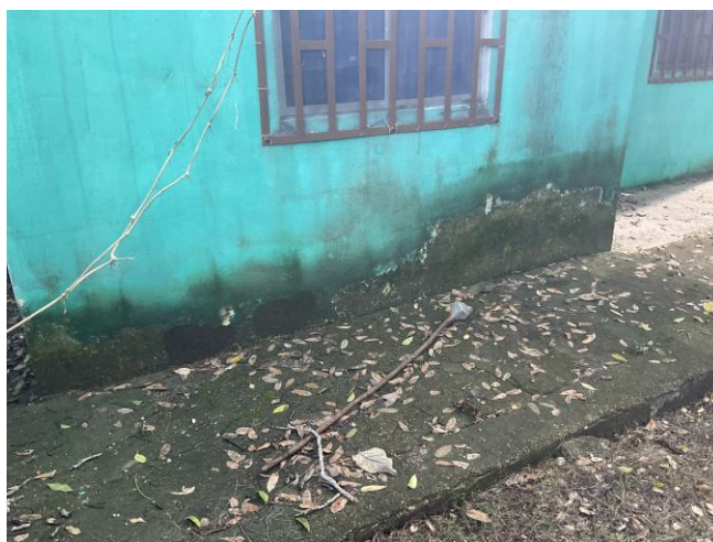
Imagen 18. Daños en muro exterior de la vivienda P2 en Palmar
