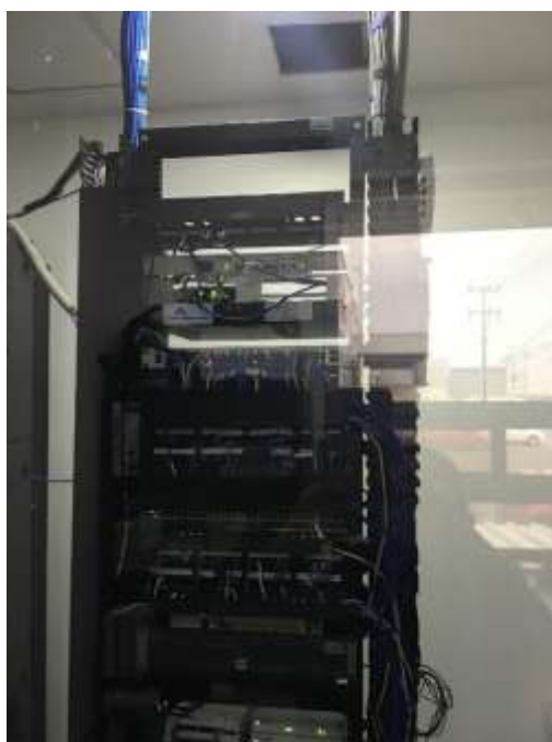
Figura 4.16 Rack donde se encuentran conectados todos los equipos de internet sucursal Almacén Cuautitlán (Autoría propia)
