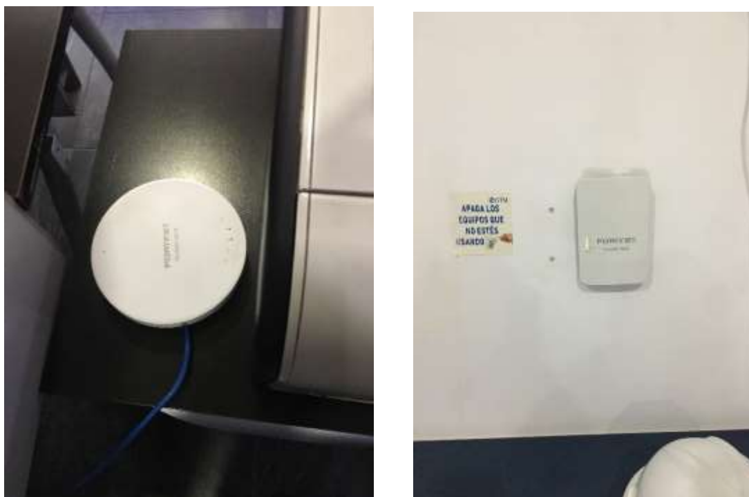
Figura 4.15 Antenas Fortinet en funcionamiento (Autoría propia)
