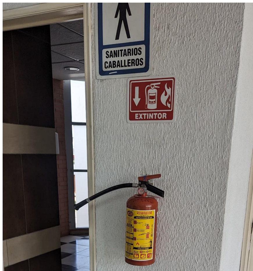
Figura 48. Sistema de Control Número 4. Evidencia 5. Foto del extintor número 3. [Fuente: Elaboración propia].
