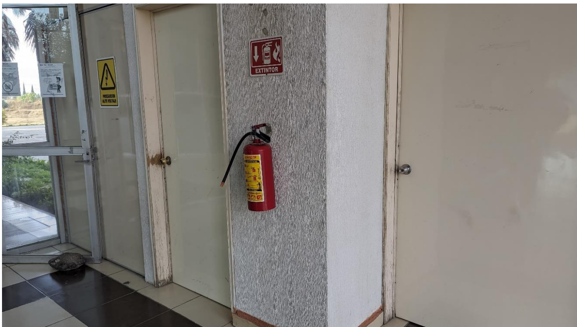
Figura 46. Sistema de Control Número 4. Evidencia 3. Foto del extintor número 1. [Fuente: Elaboración propia].
