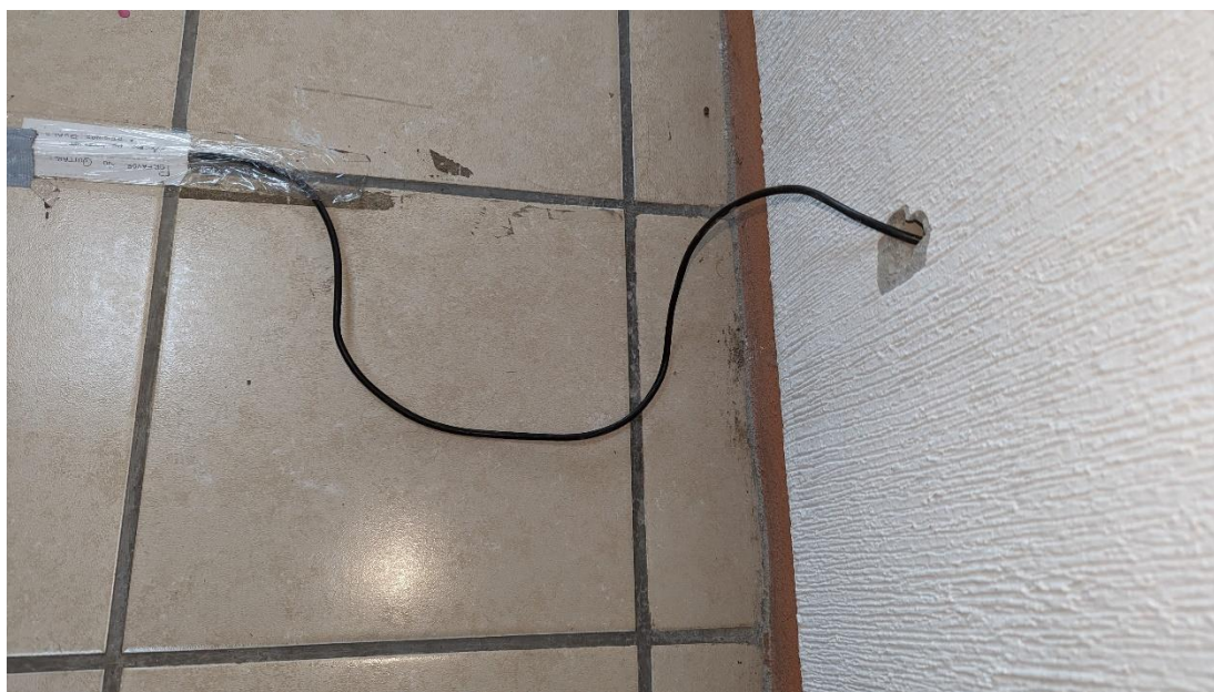
Figura 40. Sistema de Control Número 3. Evidencia 1. Salida del cable ethernet del Access Point por la pared. [Fuente: Elaboración propia].
