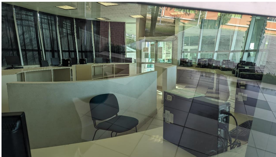
Figura 44. Sistema de Control Número 4. Evidencia 1. Foto de ausencia de extintor en el laboratorio D1. [Fuente: Elaboración propia].
