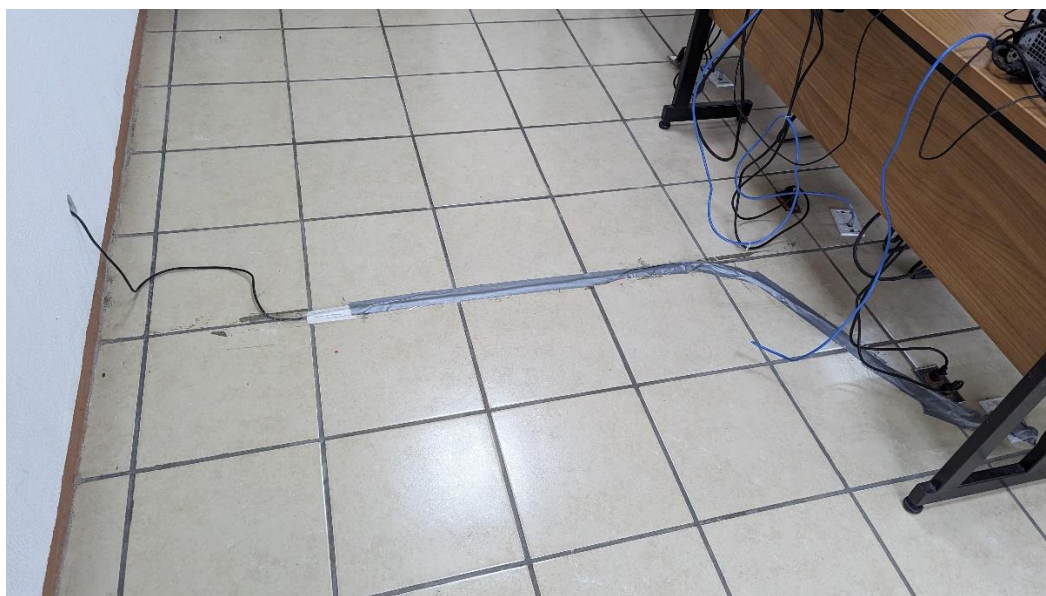
Figura 43. Sistema de Control Número 3. Evidencia 4. Foto completa del cable ethernet. [Fuente: Elaboración propia].
