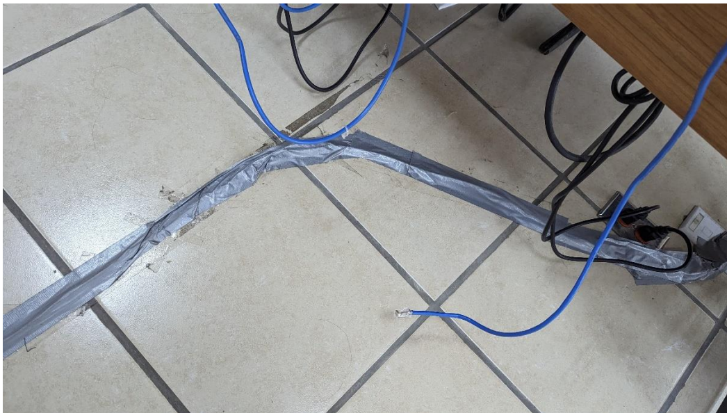
Figura 42. Sistema de Control Número 3. Evidencia 3. Conexión del cable ethernet a la terminal de red del laboratorio de cómputo. [Fuente: Elaboración propia].
