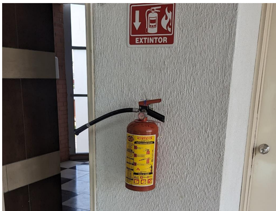
Figura 47. Sistema de Control Número 4. Evidencia 4. Foto del extintor número 2. [Fuente: Elaboración propia].
