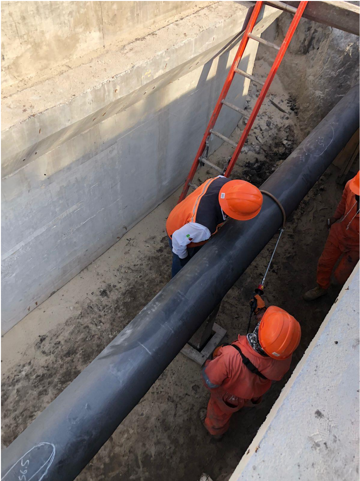
Figura 22- Ultrasonido de ducto por parte de Pemex
