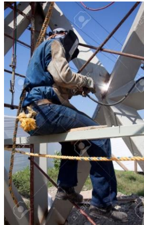
FIGURA 15 - EJEMPLO DE SOLDEO DE LA ESTRUCTURA METALICA
