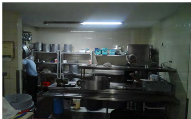
Deficiencia lumínica en área de cocina
