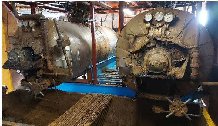
Ilustración 21. Digestores 3 y 4. Fuente: Elaboración propia.
