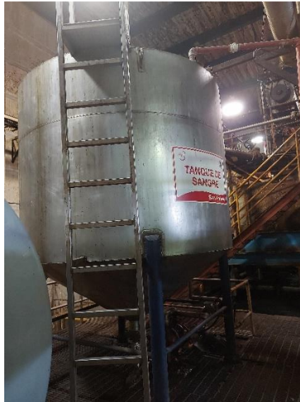
Ilustración 20. Tanque de sangre. Fuente: Elaboración propia.
