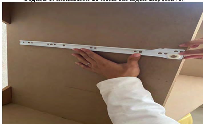
Figura 6. Instalación de rieles sin algún dispositivo.
