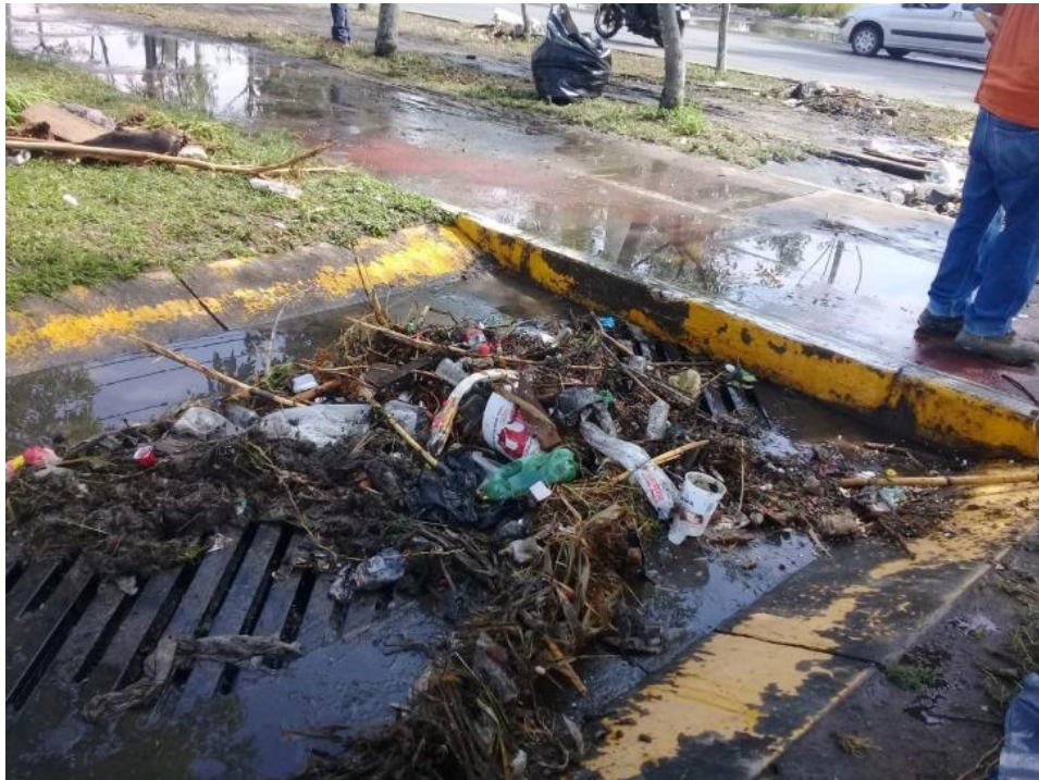
Figura 1.8 inundación por Residuos sólidos urbanos
