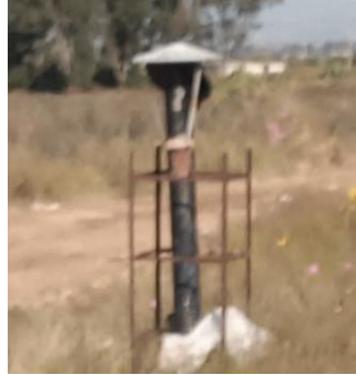
Figura 3.23 Pozo de captación de biogás del sitio de disposición final de Polotitlán, EdoMéx.
