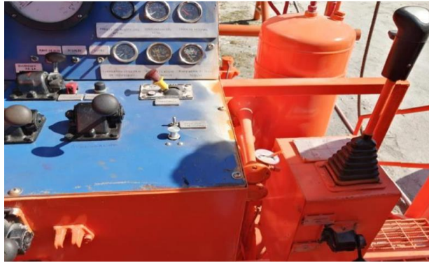
Imagen 2. 32 Panel de control. (Olam Energy)
