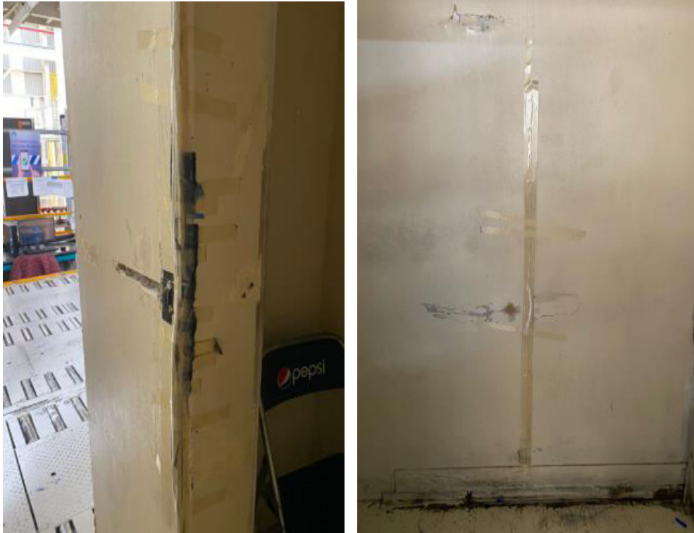
Ilustración 33. Caseta de ruido L1 en mal estado.
