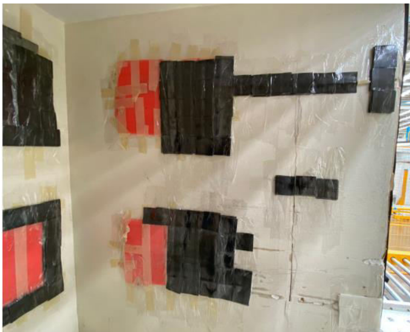
Ilustración 32. Casetas de ruido L2 en mal estado.
