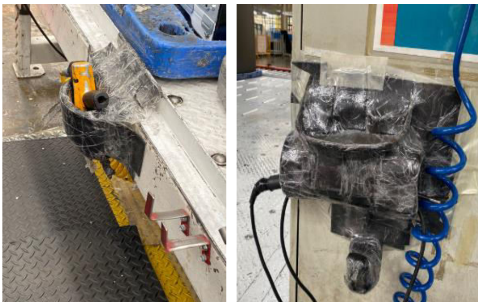
Ilustración 20. Bases de pistolas neumáticas inapropiadas
