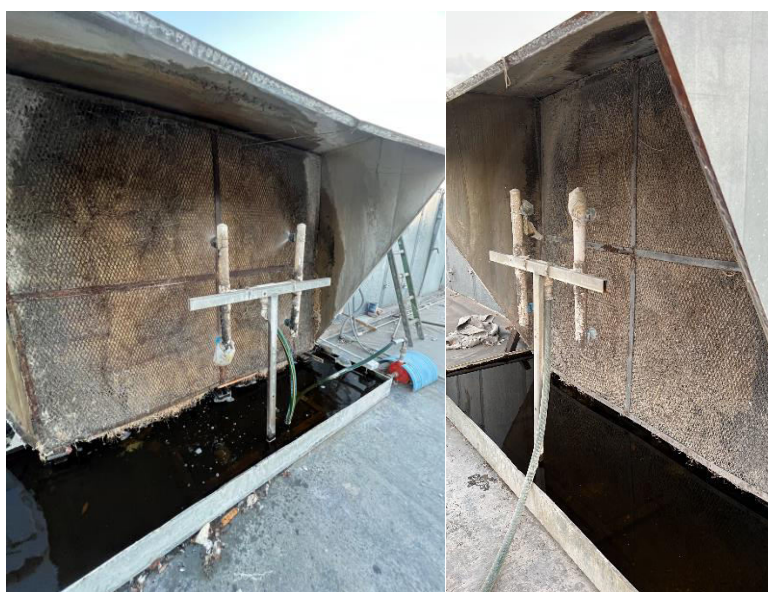
Figura 29 Nuevo sistema de humectación
