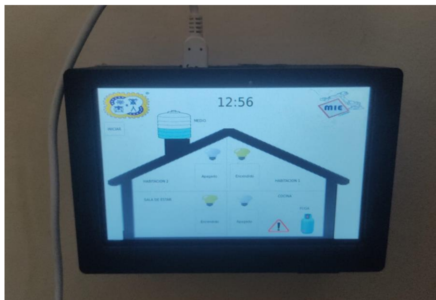
Figura 20. Sistema domótico en funcionamiento
