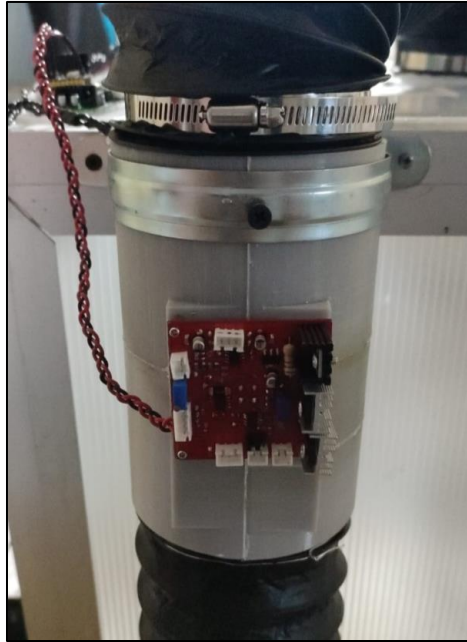
Figura 39. Sensor de gas dentro de habitáculo en su posición final en la cabina.
