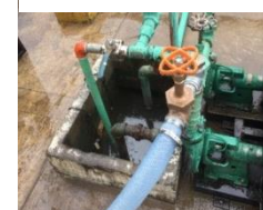
B.2 Válvula de paso del cárcamo
