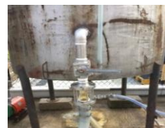
B.5 Válvula de paso del efluente clarificado
