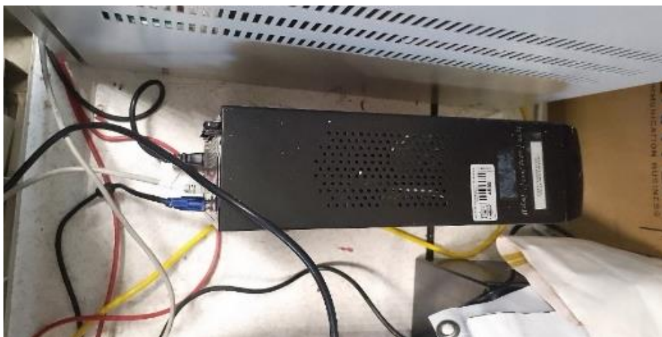
Figura 78. Cableado (Fuente: Elaboración propia, 2023)
