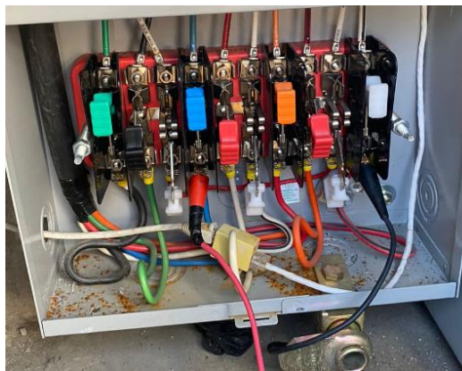
Figura 3. 28. Conexiones de Probador de TP's
