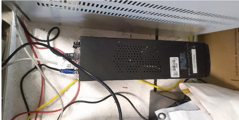
figura 9 Instalación física del servidor 1.1
