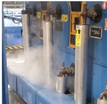
Fig. 3 Fugas de vapor a presión y abrazaderas en mal estado.
