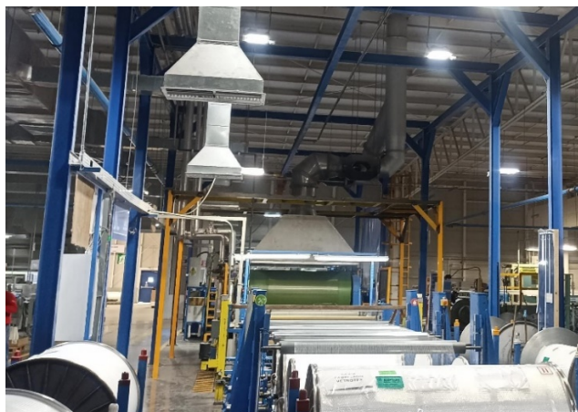
Fig. 4 Falta de pasamanos en paso de gato para mantenimiento.
