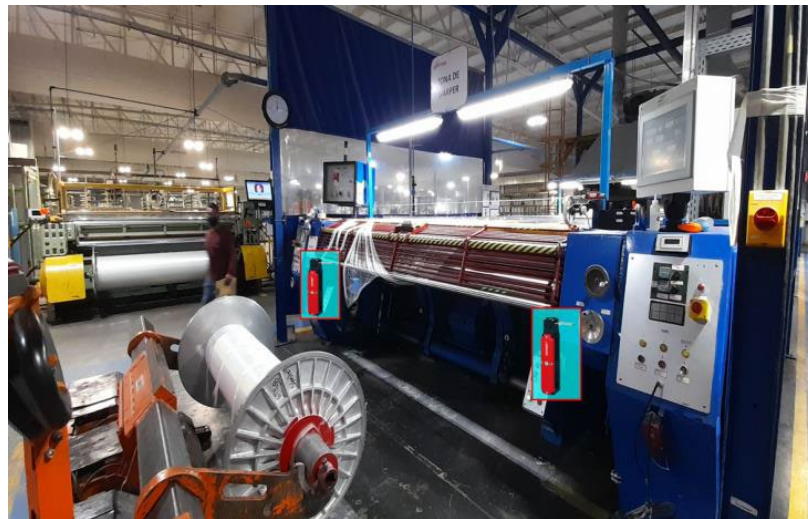
Fig. 10 Integración de interruptores con bloqueo mecánico.
