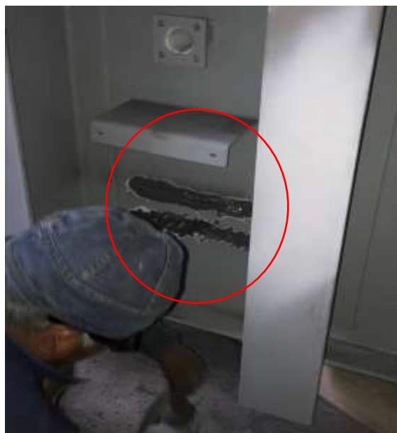
Figura 3.12 Mala fabricación [Fuente: Propia 2023]
