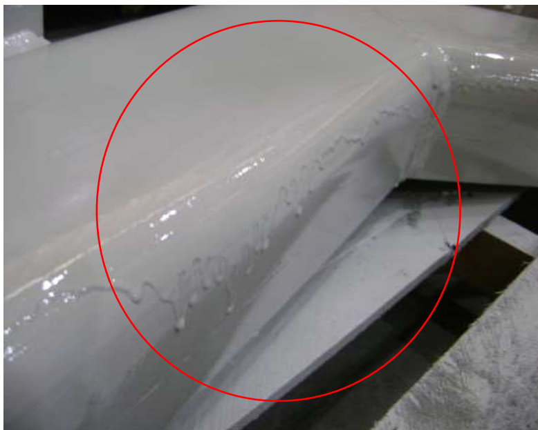
Figura 3.4 b) Escurrimiento de pintura [Fuente: Propia 2023]
