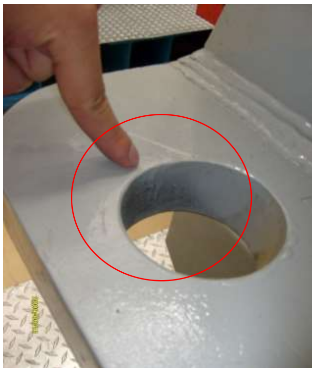
Figura 3.3 b) Falta de pintura [Fuente: Propia 2023]
