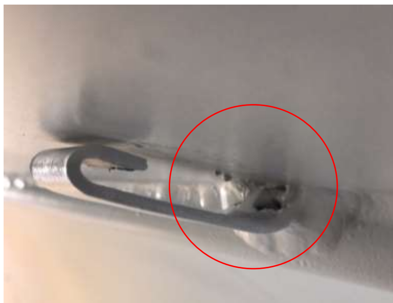
Figura 3.7 Falta de soldadura [Fuente: Propia 2023]
