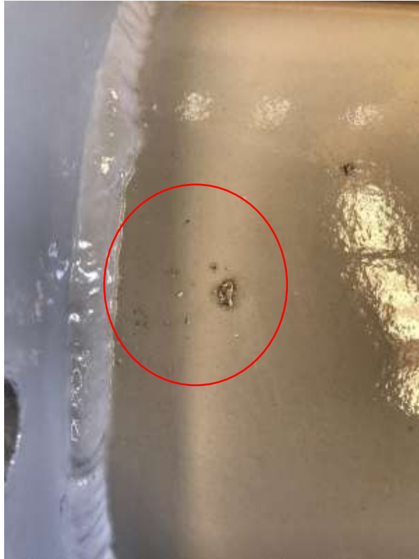
Figura 3.13 Mal acabado [Fuente: Propia 2023]
