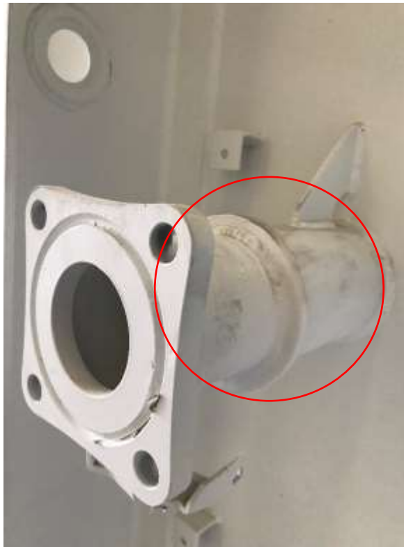
Figura 3.14 Falta de limpieza [Fuente: Propia 2023]
