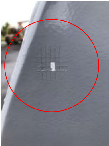
Figura 3.5 a) Falta de adherencia [Fuente: Propia 2023]
