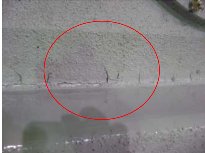
Figura 3.5 b) Falta de adherencia [Fuente: Propia 2023]
