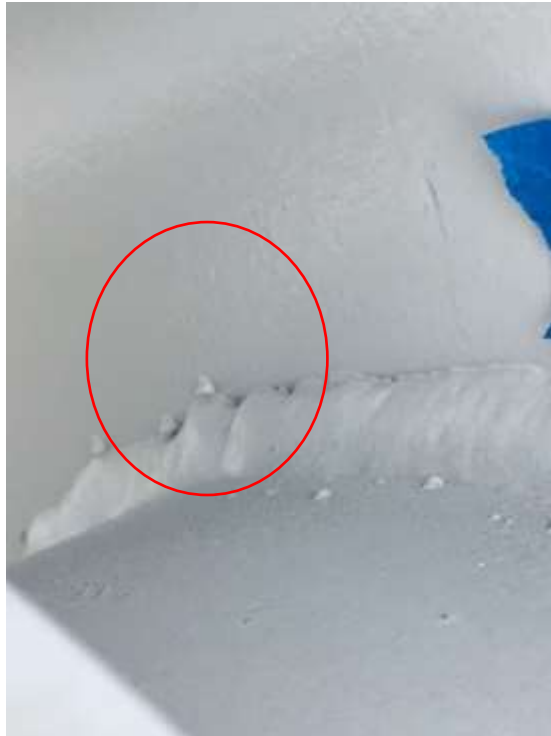
Figura 3.10 Socavado en soldadura [Fuente: Propia 2023]
