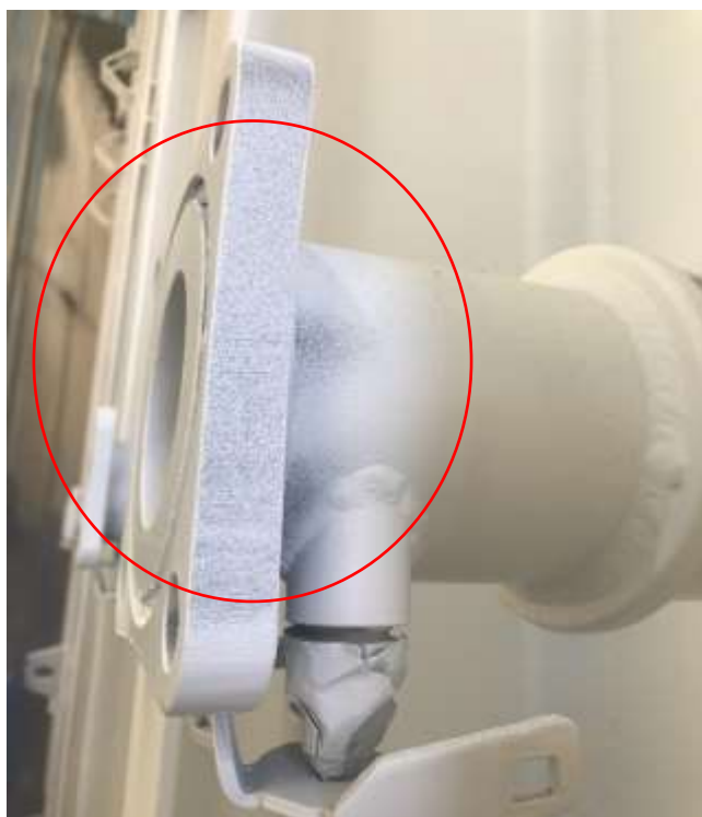
Figura 3.3 a) Falta de pintura [Fuente: Propia 2023]
