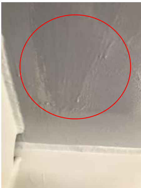
Figura 3.4 a) Escurrimiento de pintura [Fuente: Propia 2023]
