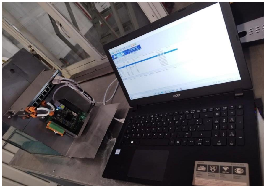
Ilustración 67. Intercomunicación terminada entre el switch, tarjeta de comunicación, software
