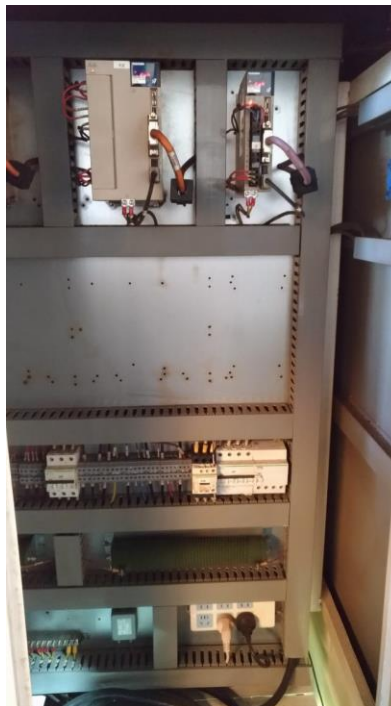
Figura 11. Interior del gabinete de control (propiedad de COMETAL).
