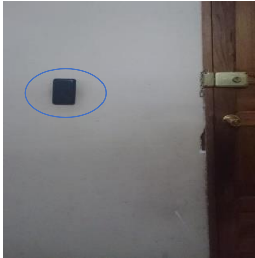
Figura 21. Implementación de sistema en la puerta principal. Imagen propia.
