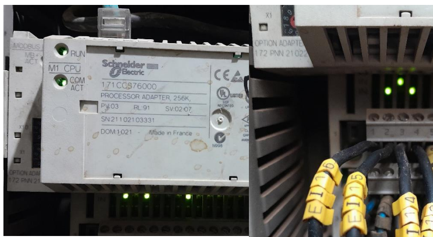
Figura 5.19. Verificación de señal mediante los indicadores luminosos.
