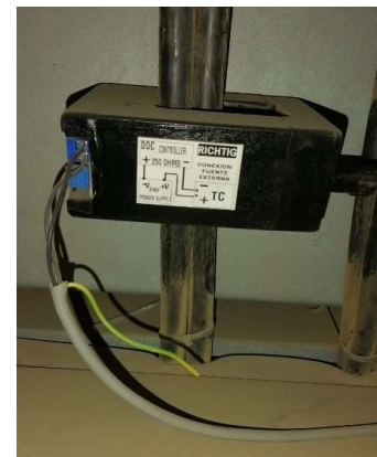
Figura 3.34 (Transformador tipo dona en funcionamiento)
