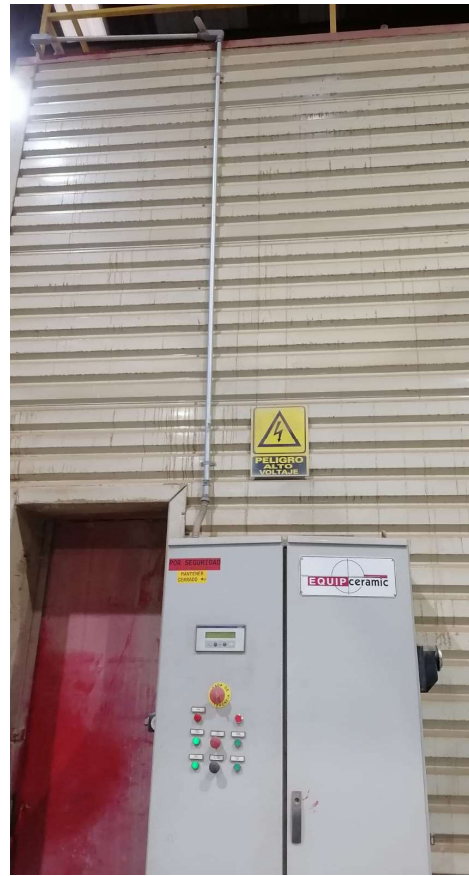
Figura 3.6 (Tubería instalada de PLC a PLC)
