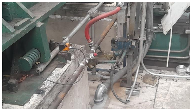
Figura 3.33 Sensor inductivo para indicar el final de carrera de canal de entrada.
