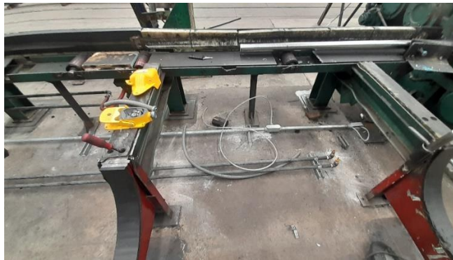
Figura 3.72 Instalación de accionamiento de pedal para el control de los topes.
