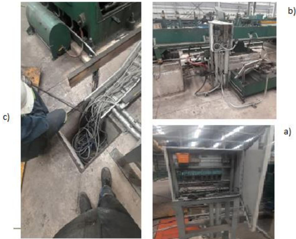
Figura 3.7 Identificación del recorrido del cableado a modificar.
