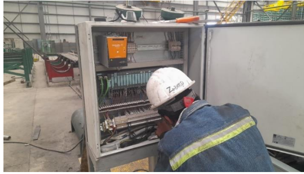
Figura 3.34 Identificación de señal del sensor de limitación de carrera del canal de entrada.
