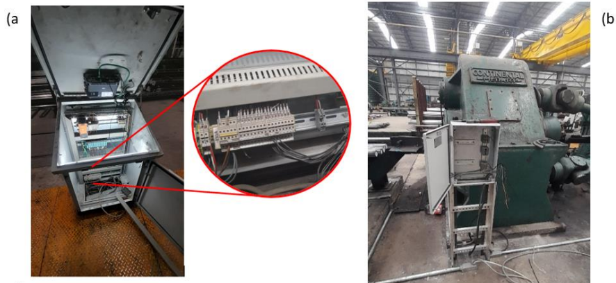
Figura 3.59 Recorrido para la alimentación del tablero “D”.
