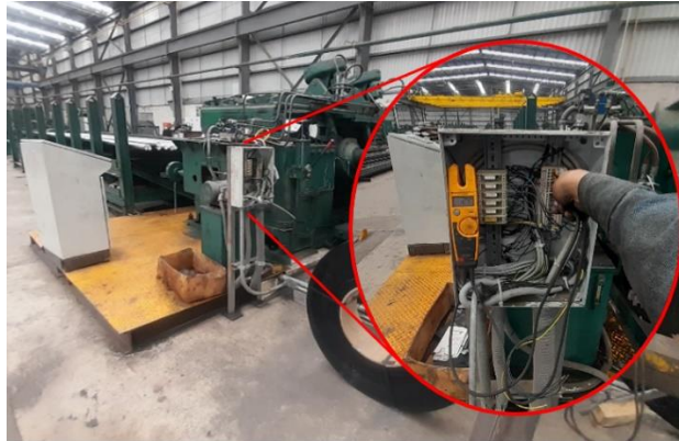
Figura 3.58 Identificación de tomas de alimentación para voltaje de 24 VCD.
