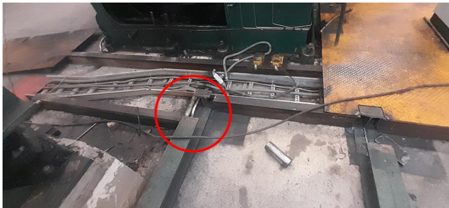
Figura 3.6 Canalizaciones eléctricas ubicadas debajo de la bancada de entrada.
