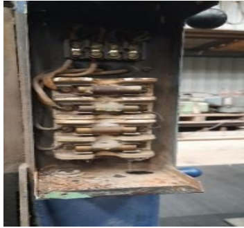
Figura 3.83 Caja de fusibles obsoleta y en mal estado por el óxido y suciedad adherida.
