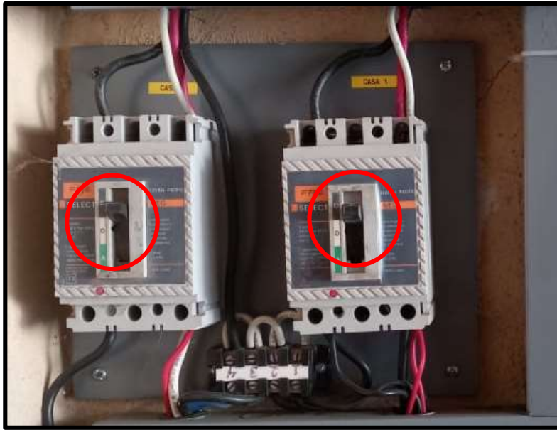
Figura 49 Fases tomadas de los dos Interruptores Termomagnéticos IEA [Fuente propia 2023]
