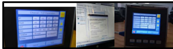
Figura 113 Identificación de PLC [Fuente propia 2023]
