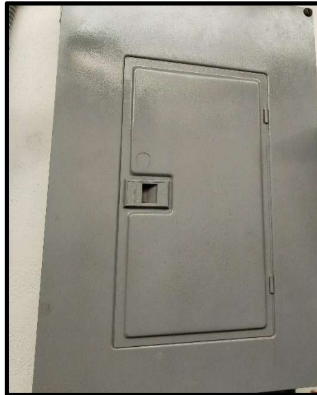
Figura 56 Tablero de Distribución Instalado IEA [Fuente propia 2023]
