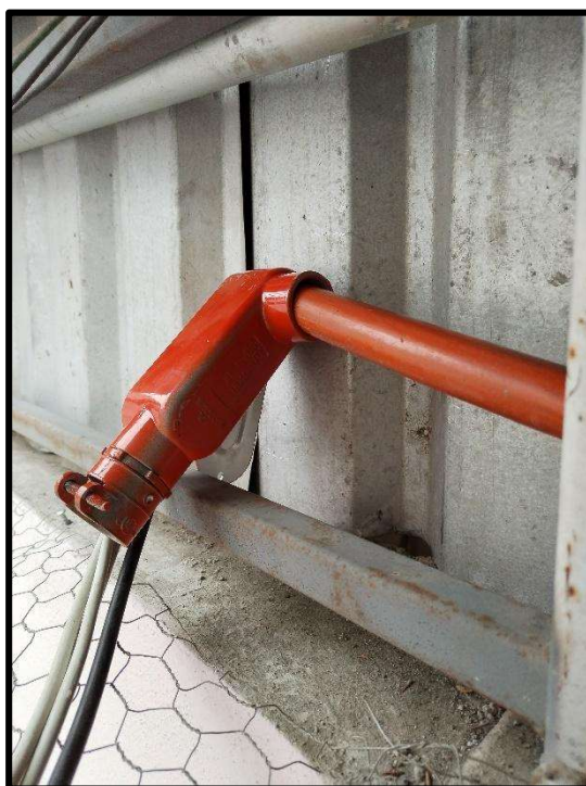
Figura 53 Utilización de Condulet Tipo LB [Fuente propia 2023]
