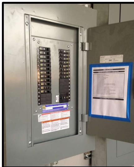
Figura 35 Tablero eléctrico [Fuente HOFFMAN 2023]
