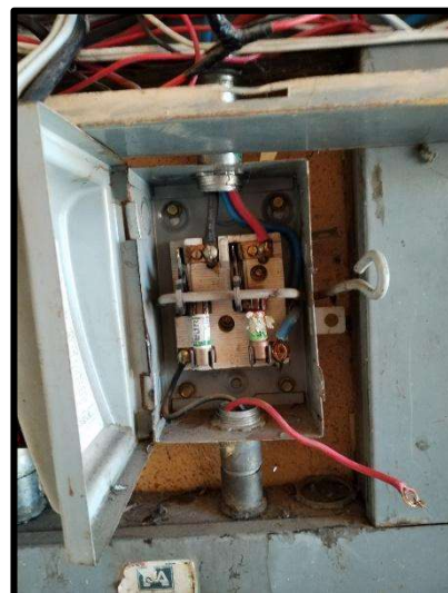
Figura 6 Caja de Cuchillas de Segundo Medidor 2023[Fuente propia 2023]
