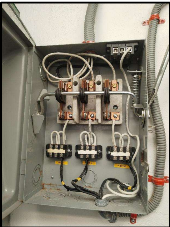
Figura 7 Interruptor de Cuchillas Instalado [Fuente propia 2023]
