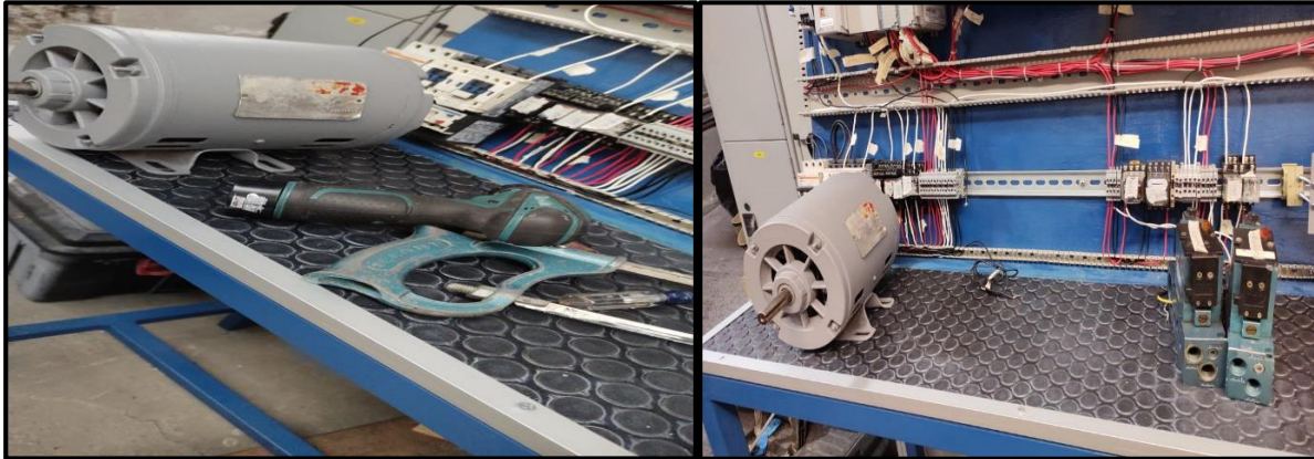
Imagen 3.8 Motor y electroválvulas
