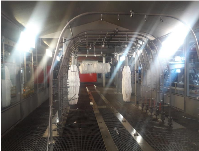
Imagen 6. Estación de la lavadora [Fuente VWM, Autor VWM, 2017]
